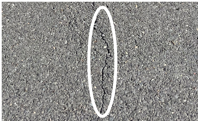
Det er revner som disse vi skal have forsejlet
