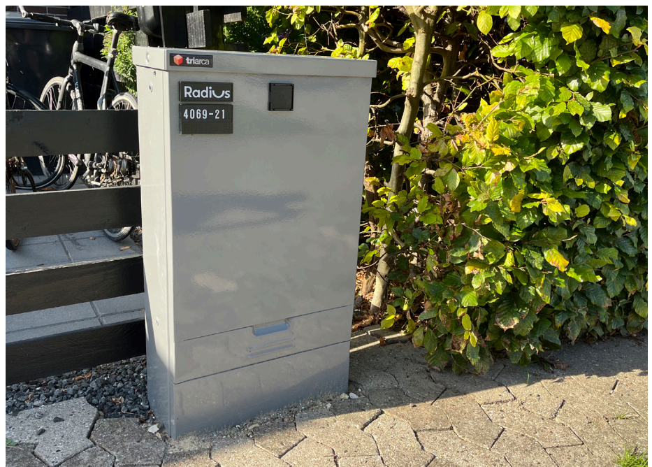
Et af de el-sikringskabe der skal trækkes strøm fra.
