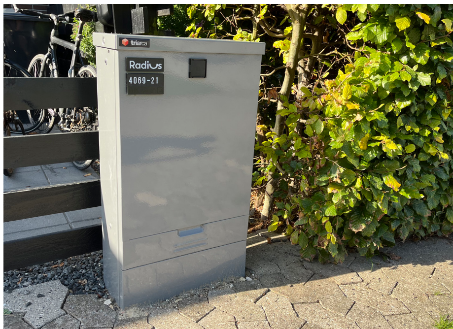
Et af de el-sikringsskabe der skal trækkes strøm fra.
